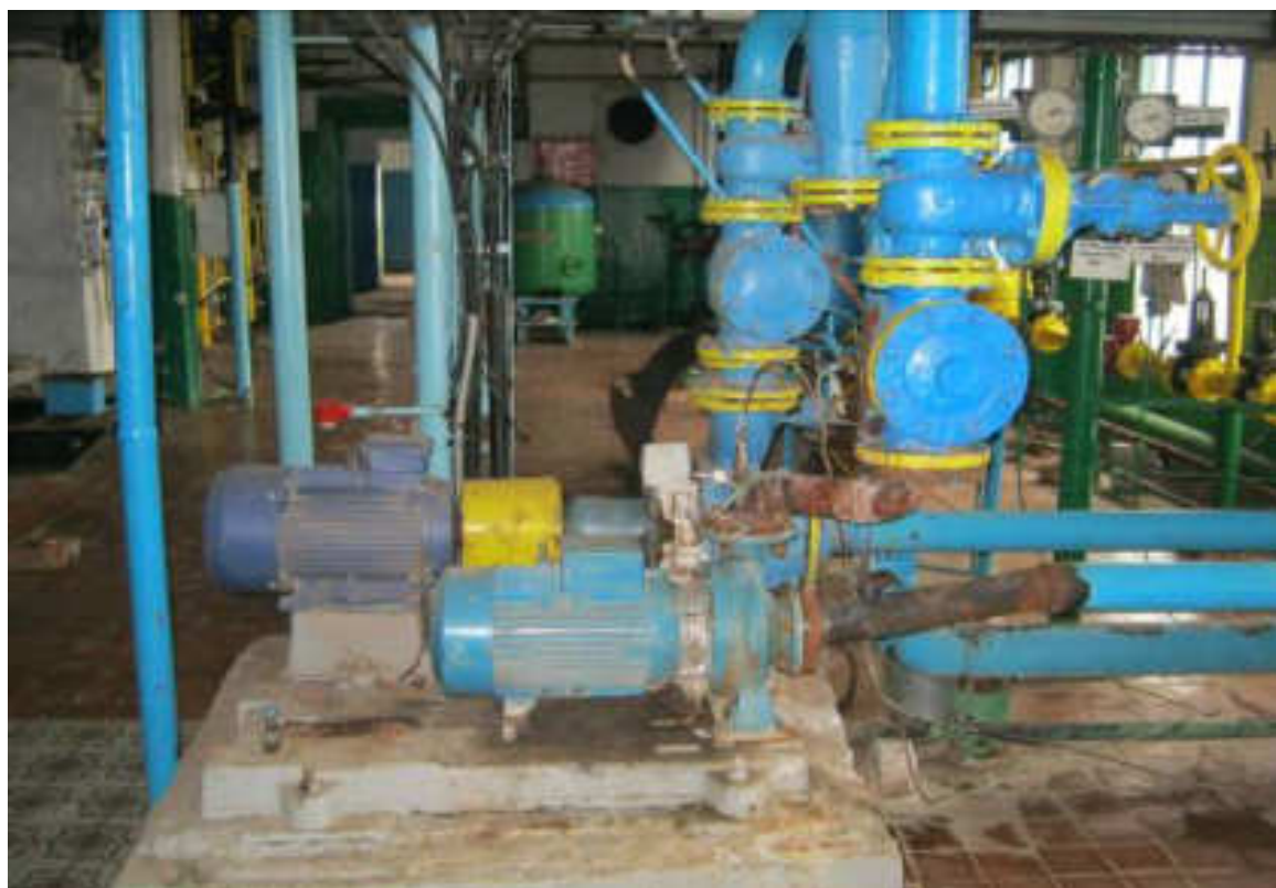
Видимое изображение №3 Трубопроводы обвязки и котлоагрегаты
